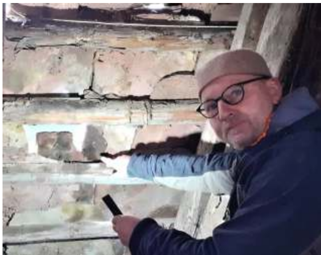
Inspektor Frank Wehmeier erkundet Dachleckagen
